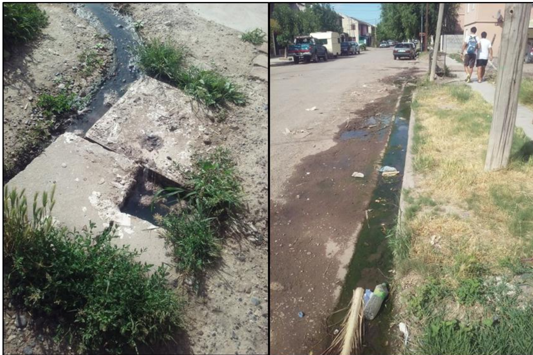
Figura 5 (izq). Desborde cloacal en boca de registro, calle Dorrego entre México y Estados Unidos (19/12/18). Figura 6 (der). Líquido cloacal escurriendo sobre calle Dorrego (19/12/18).
