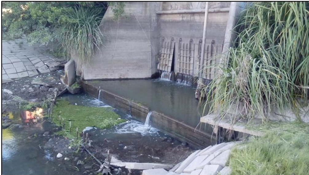
Figura 9. Líquido descargando a través de las compuertas de la estructura de Ayacucho y B.Villarino, que no se corresponde con escurrimiento pluvial (03/12/18)
