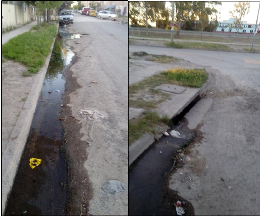
Figuras 7 y 8. Líquido proveniente de desbordes cloacales del barrio Ceferino, escurriendo sobre cordón cuneta de calle México e infiltrándose en boca de tormenta de Ayacucho y México (03/12/18).
